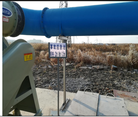
盛大环保公司事故应急池照片
