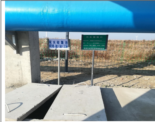
盛大环保公司尾水收集池及污水排放口
