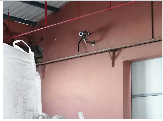
危废仓库大门口摄像头
