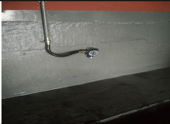
危废仓库内部可燃气体报警器
