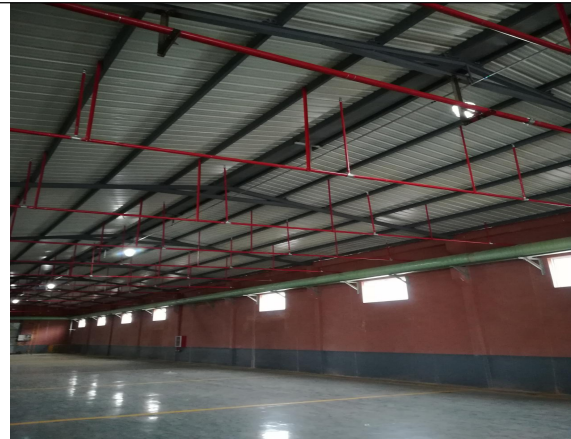
危废仓库内部防腐防渗地坪和裙脚
