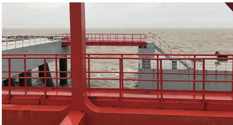
图3.1-7 北侧泊位工作平台同靠船墩钢人行桥
